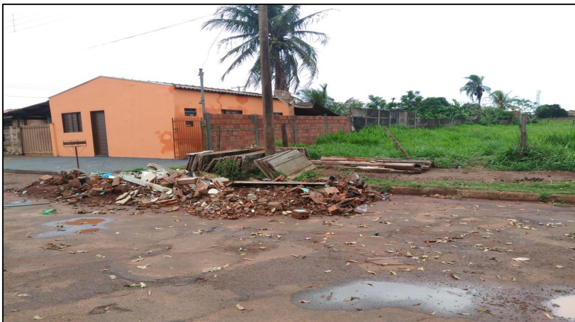
Figura 53: Pontos clandestinos de resíduos da construção civil e de demolição na cidade de União de Minas, MG.
